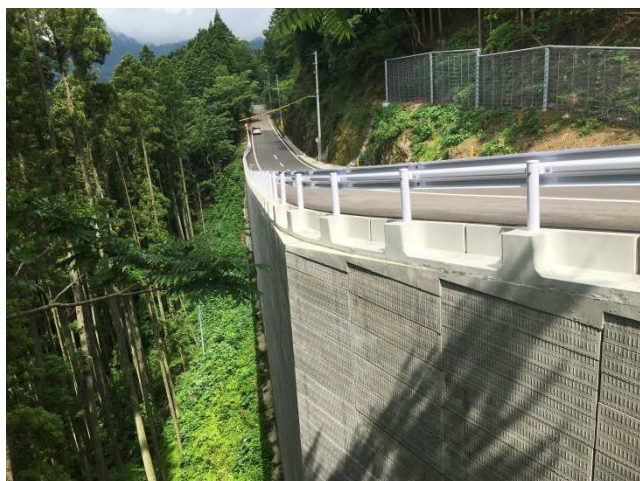
写真-3 調査箇所③震災後壁面状況
