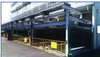
①機械式駐車場
