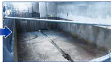
③地下ピット
